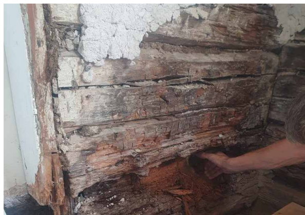
Omfattande i rötskador i gamla diskrummet.
