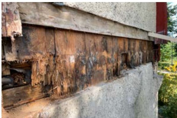
Rötskada upptäcktes vid balkongen på Södra flygeln.
